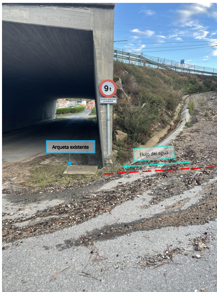
IMAGEN 3-28: IMAGEN DEL PUNTO DE VERTIDO (EN ARQUETA PREEXISTENTE)
