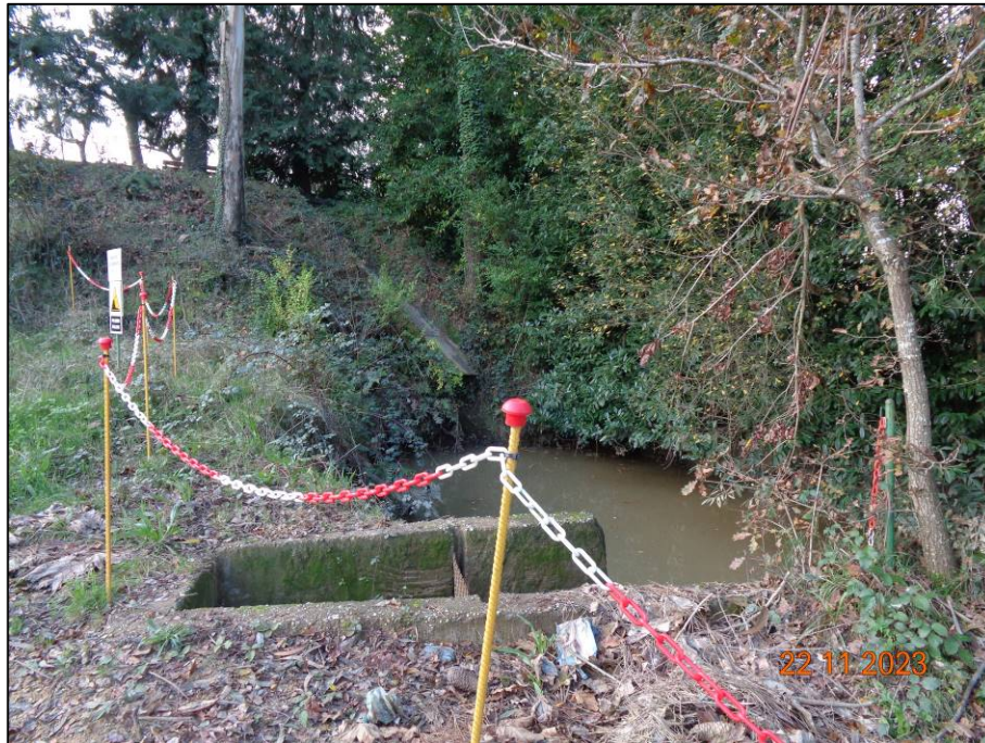
Foto 19. Balsa de escorrentía nº 3.
