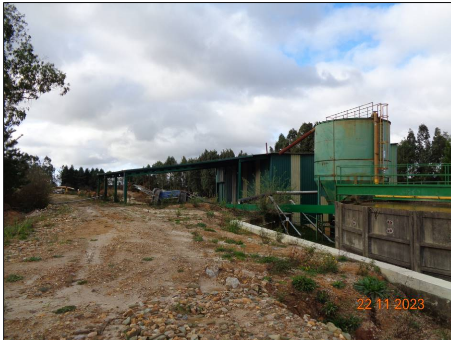
Fotos 13 y 14. Filtro prensa y decantador.
