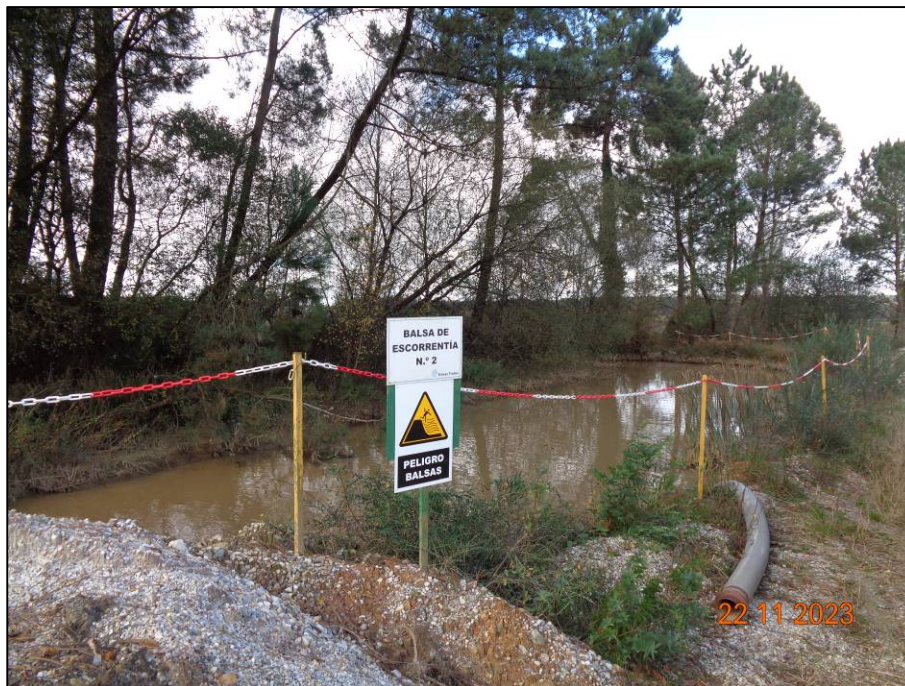
Foto 18. Balsa de escorrentía nº 2.
